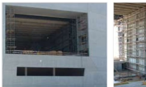
Casa Da Musica, Porto, Portugal, em construção no ano de 2002. Foi especificado apoios TICO anti - vibraticos de estruturas e apoios de deslizamento
